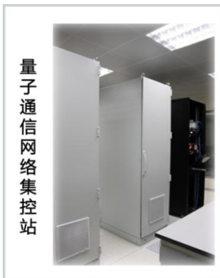
图 20：量子通信网络集控站
